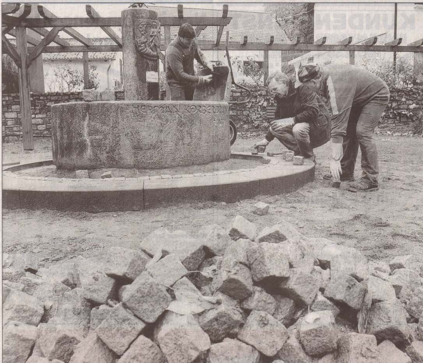
Klaus Assmann, Heinz-Dieter Molitor und Philipp Kreis (von links) pflasterten die Brunneneinfassung auf dem Körperplatz.
